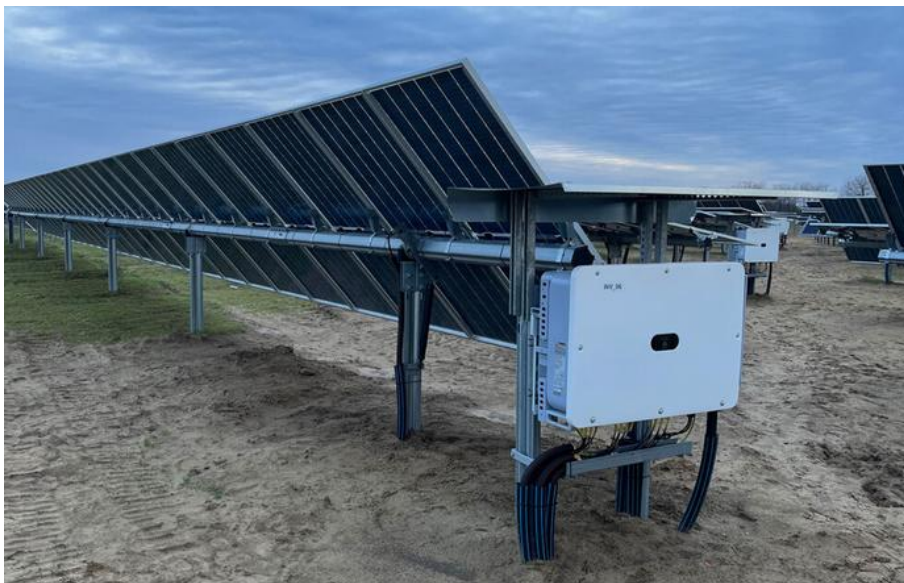
Altri esempi di tracker installati e di posizionamento di inverter di campo
