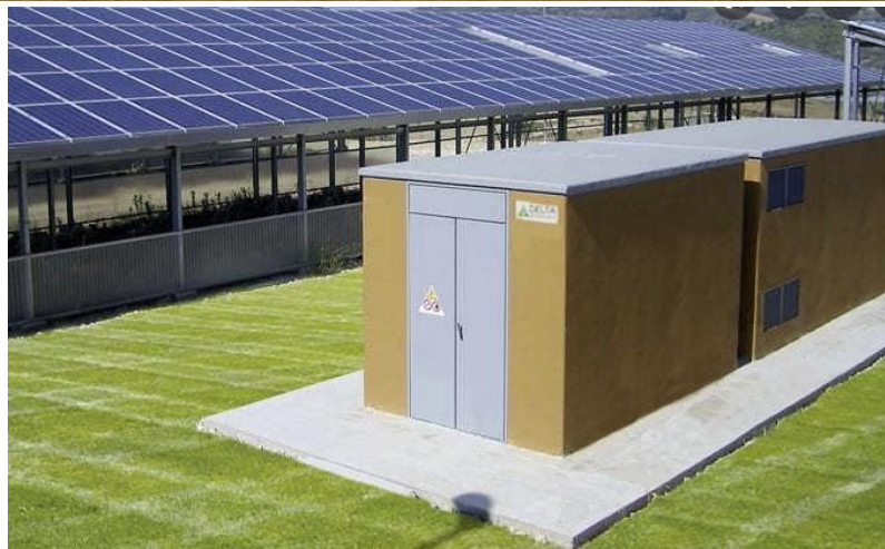
Fig. 27 – esempi di cabine di campo in diverse colorazioni
